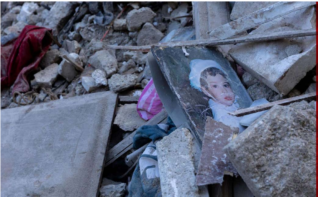
Dans un immeuble d'habitation effondré à Alep. © Hope Center Aleppo / L'Aide à l'Église en détresse
